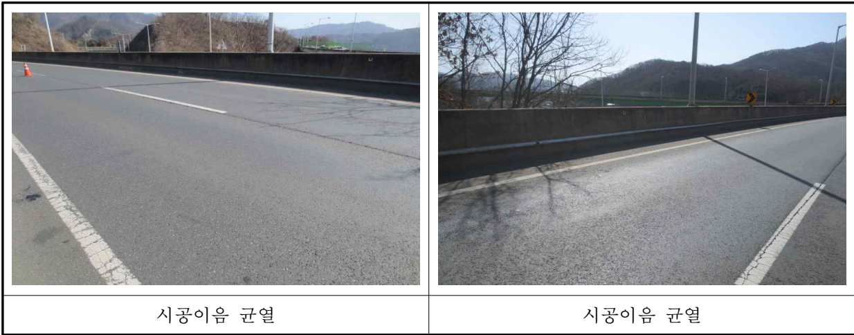
[표 5.24] 금남IC Ramp-C교 교면포장 손상물량표
